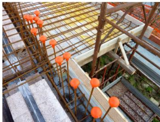
2. Stato avanzamento lavori per la realizzazione dei terrazzi (coibentati con pannelli in poliuretano) e dei cordoli in c.a. (coibentati con pannelli in fibra di legno)
