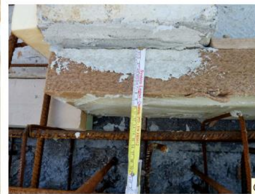
7. Verifica dello spessore del pannello coibente in fibra di legno (sp.=8 cm)
