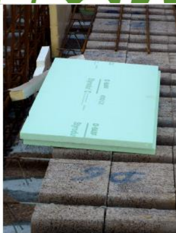
1. Pannelli di poliuretano per la coibentazione dei terrazzi
